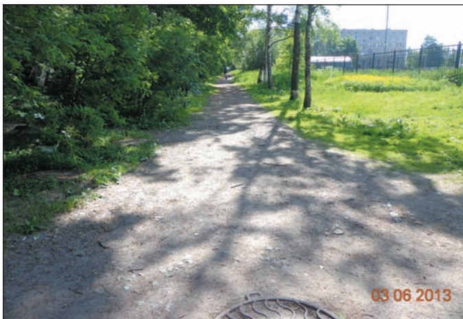
Пешеходная дорожка у дома 187 по пр. Народного Ополчения до ремонта
